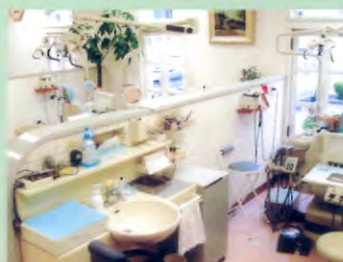
ユニットの仕切り内には電源などを配線
