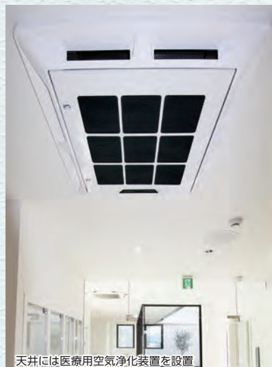
天井には医療用空気浄化装置を設置
