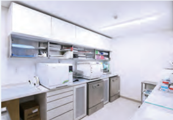
滅菌器などがフル稼働する消毒・滅菌スペース
